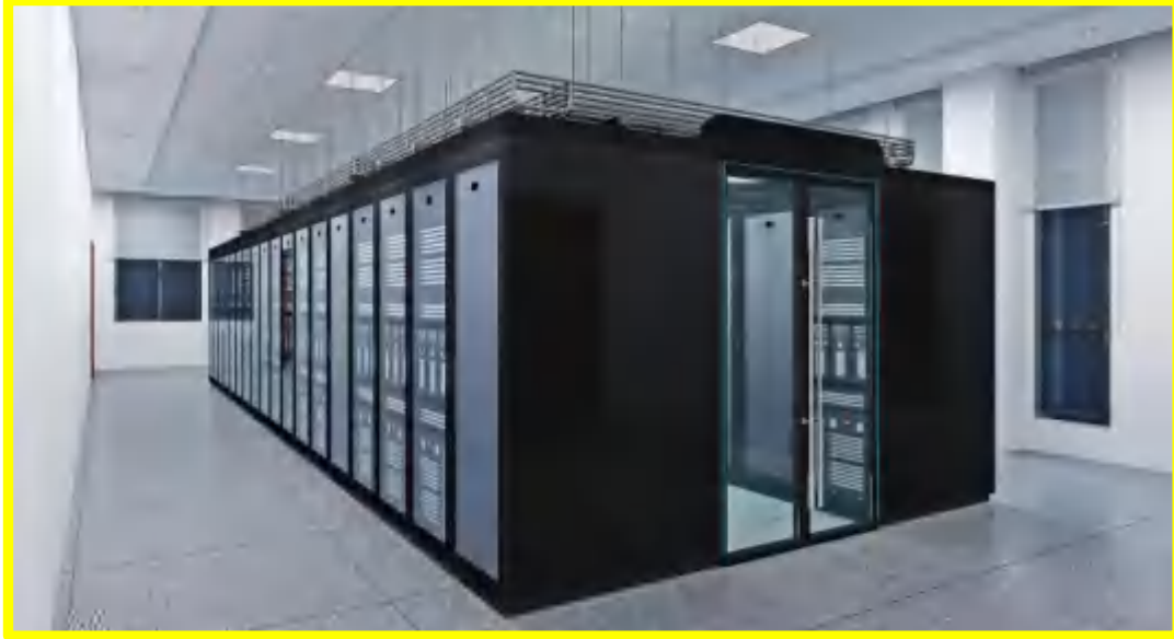
图 3 运行中的微模块数据中心
